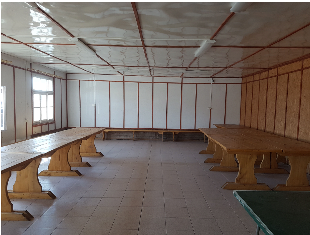
Zdjęcie Nr 5 – ściany i sufity sala nr 1
