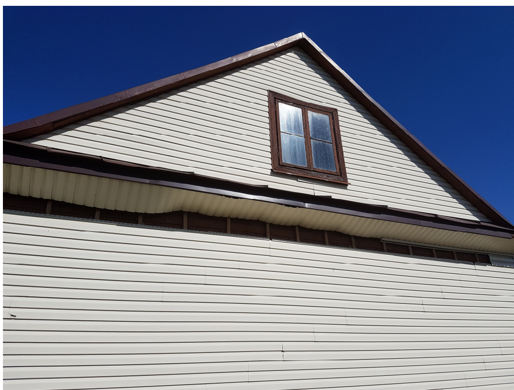
Zdjęcie Nr 4 – elewacja i podsufitka okapu
