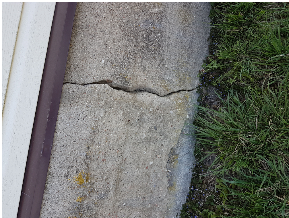
Zdjęcie Nr 3 – spękany fundament budynku
